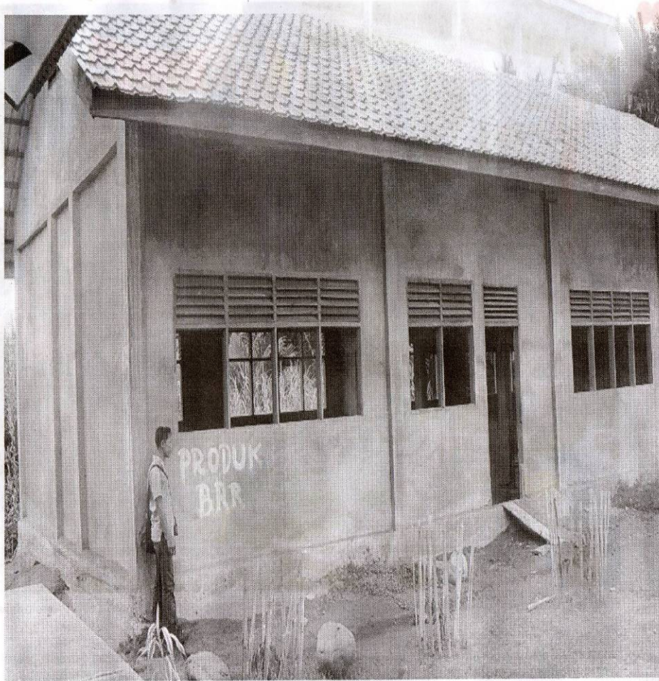
Kondisi bangunan kelas MIN Blang Balee, Samatiga, Aceh Barat yang belum rampung pembangunannya.
